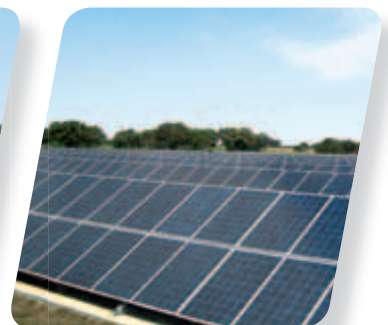
Alentejo, Portugal: Central Fotovoltaica com módulos Suntech
